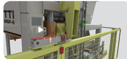
Grades de segurança. Protection fences. Rejas de seguridad.
